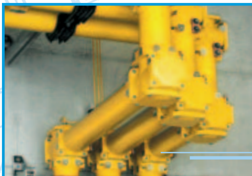
GL 12 kV – 2500 A
