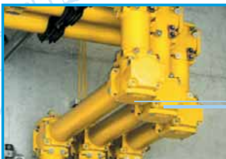
GL 12 kV – 2500 A
